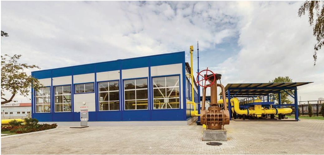
ГРП «Южная ГС», ОАО «Мосгаз» (г. Москва)
