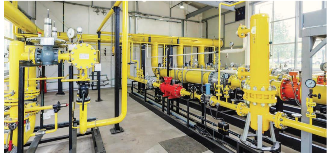
ГРП «Тёплый Стан», ОАО «Мосгаз» (г. Москва)
